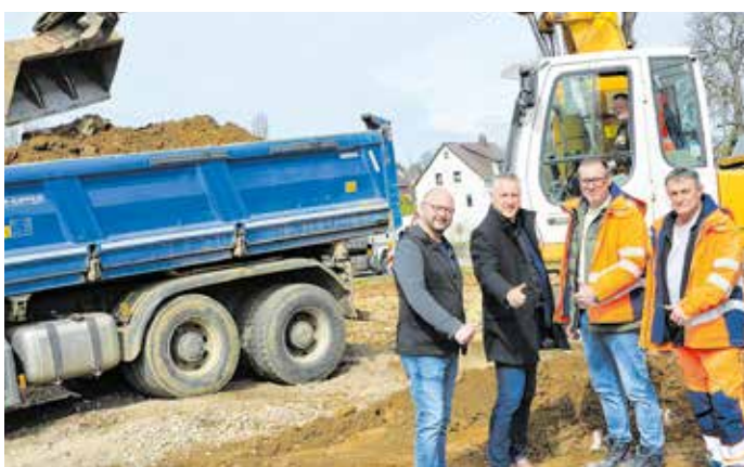
Bürgermeister Röthig, Landrat Michaelis, Bauleiter Wagenknecht und Polier Vetterlein auf der Baustelle „Wolfsschlucht“ Foto: Büro Kommunikation und Wirtschaftsförderung
